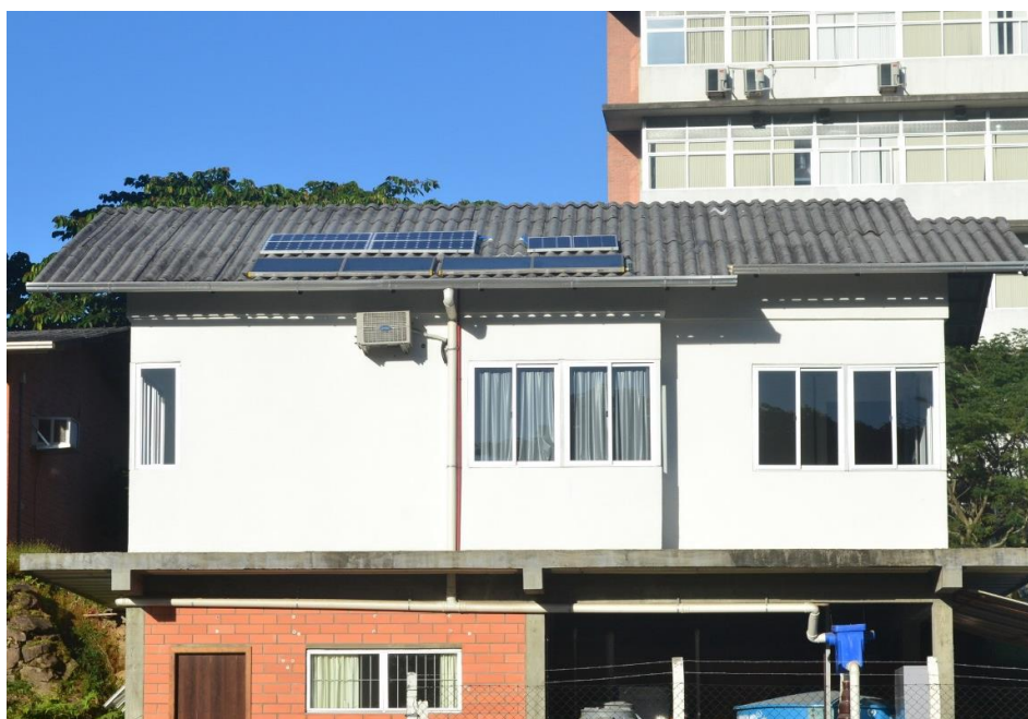
Figura 2 – Painéis Fotovoltaicos e de Aquecimento de Água.
